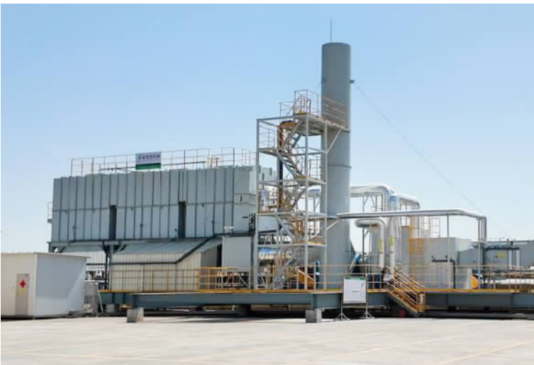
■世发(广佛)印刷包装产业园配置转轮+RTO蓄热燃烧系统设备,实现有机废气统一收集处理。
