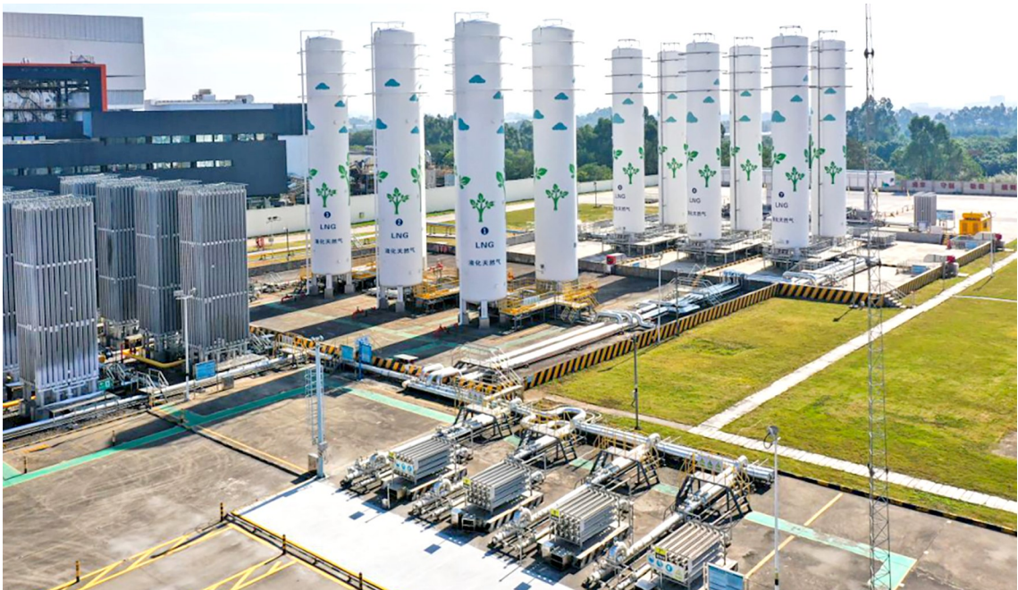
■瀚蓝南海燃气狮山LNG综合储配站。
