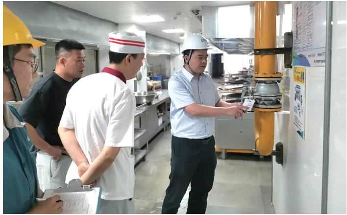
■工作人员对供气考点开展燃气设施全面排查和检测。
