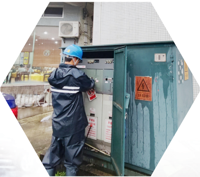
供电运维人员冒雨对受水浸影响的设备进行隔离停电。
