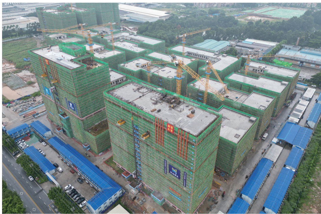
■南海粤海智能制造产业园一期17个单体主体结构全部封顶。
