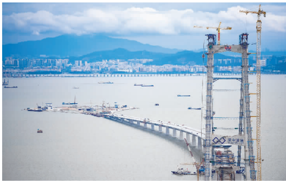
■深中通道伶仃洋大桥东塔、西人工岛及远处的深圳市区（2022年6月7日摄）。 新华社发
