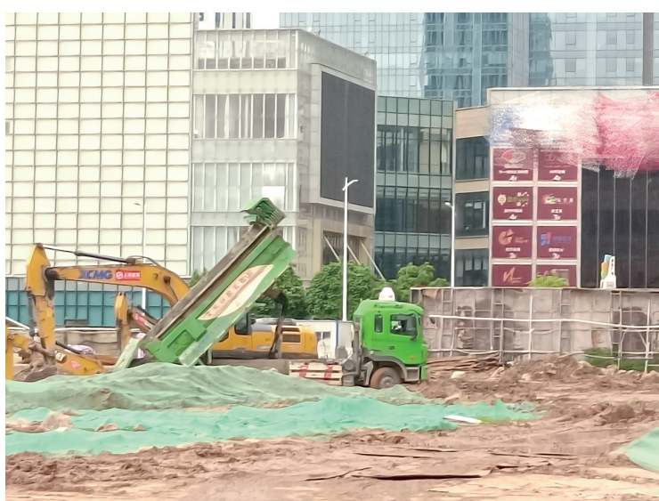
■工地违规处置建筑垃圾现场。
