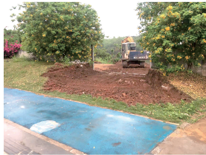
■现场挖出一条长约5米的路坑,影响市容市貌。(通讯员供图)
