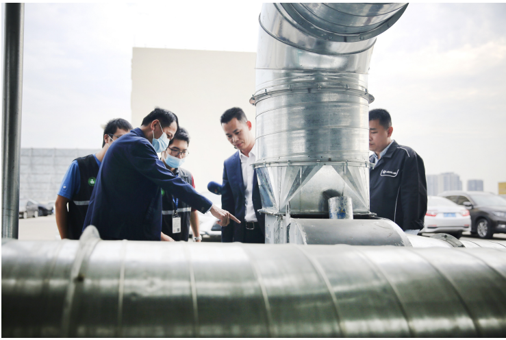
■检查组对一家企业废弃排放口的离心通风机进行查看。
