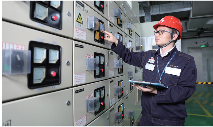
■关家华在检查机房。
