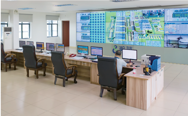
■中心控制室是南海第二水厂的中枢大脑,24小时监控制水生产工艺和过程。
