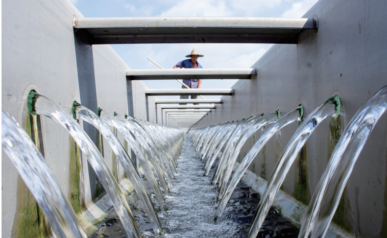
■混凝反应后的原水经过平流沉淀池的沉淀作用进入滤池进行过滤。
