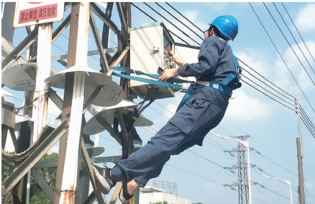
■南海供电局配网综合班作业员对10KV线路的自动化设备进行自动化定值调试。
