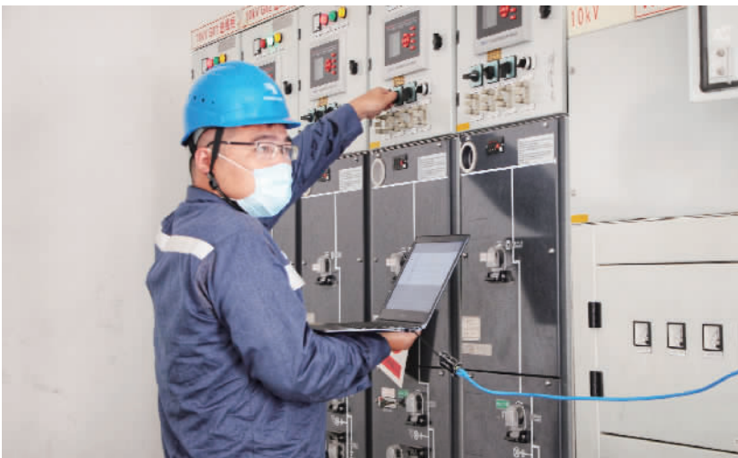
■南海供电局桂城供电所工作人员查看线路自动化开关测控终端通讯运行情况。
