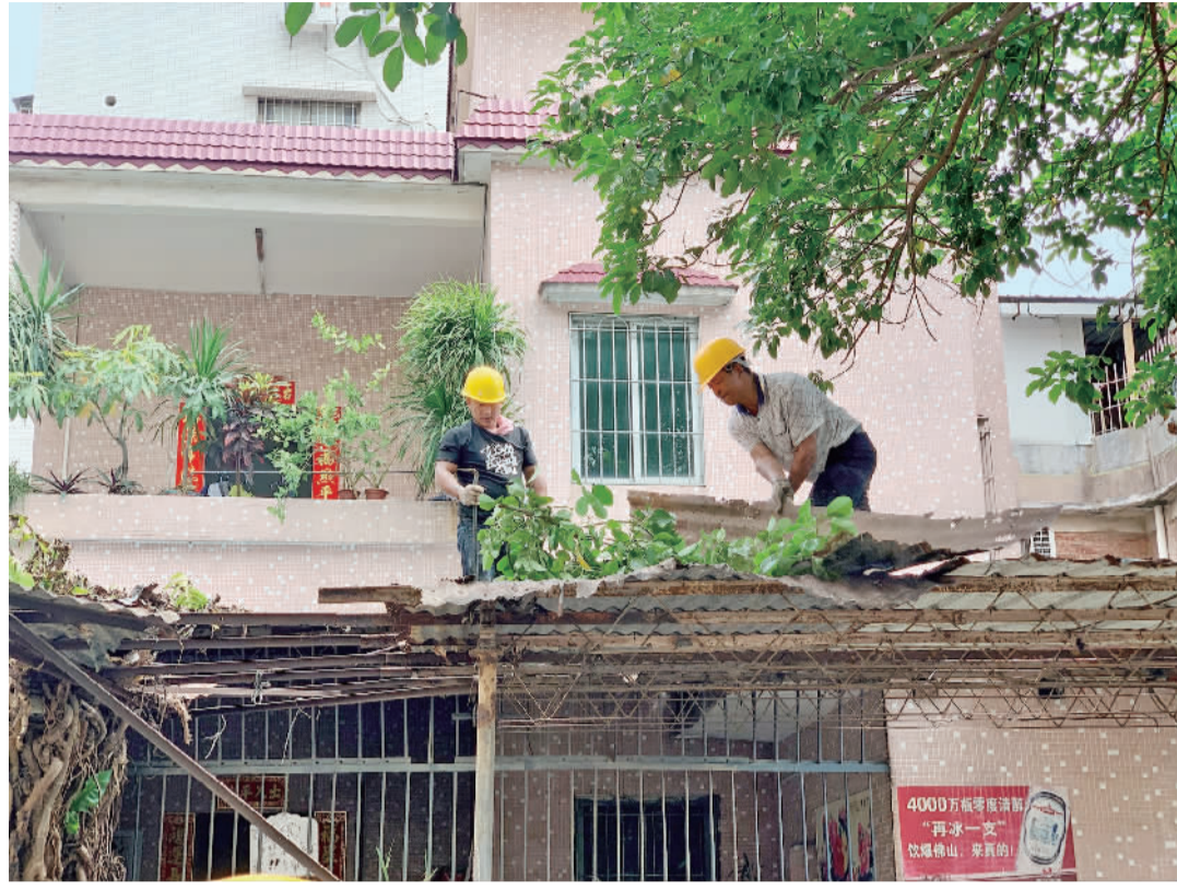
■中区社区村民自建违建雨棚屋。
