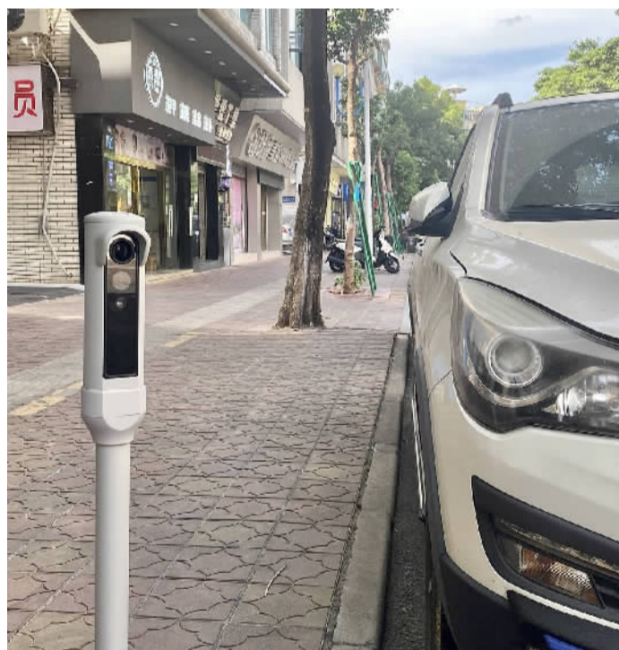
目前,东升路已安装上视频桩等智能化设备。
