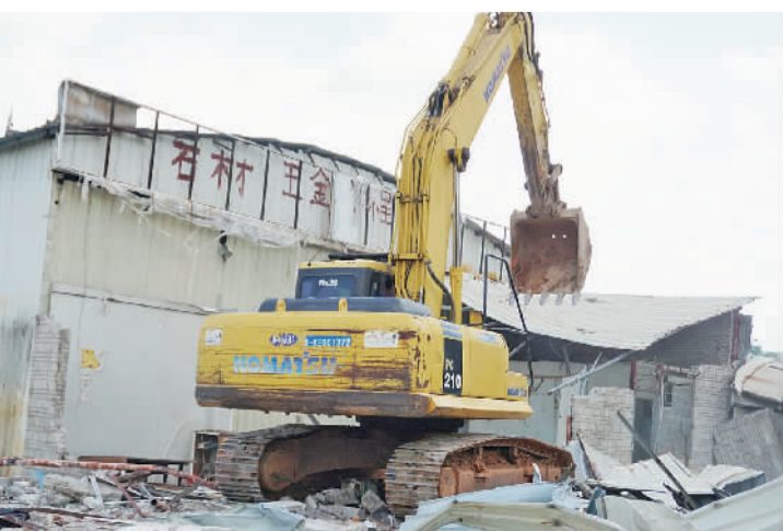
■罗村执法中队联合消防、公安等部门,对科技大道东一侧违法建筑物实施拆除。
