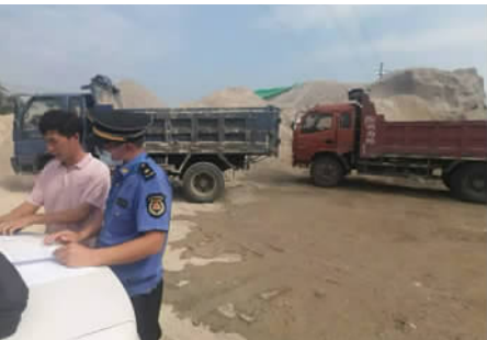
■消纳场整改前没掩盖。
