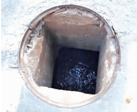
■机动车道上有一井盖缺失。
