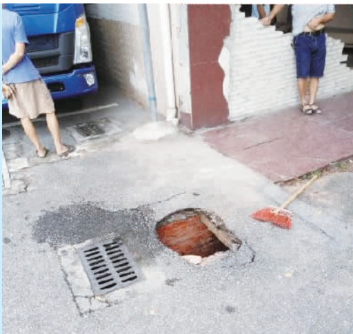
■井盖缺失隐患大。
