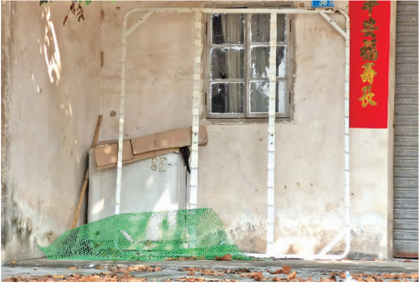
■镇涌二路36号,乱堆放杂物。
