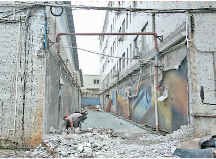
■企业封闭的消防通道已经打通。
