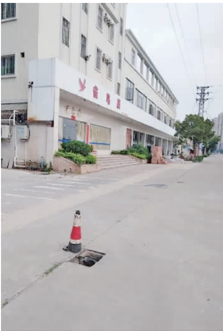
■雨水箐子破损存在安全隐患。
