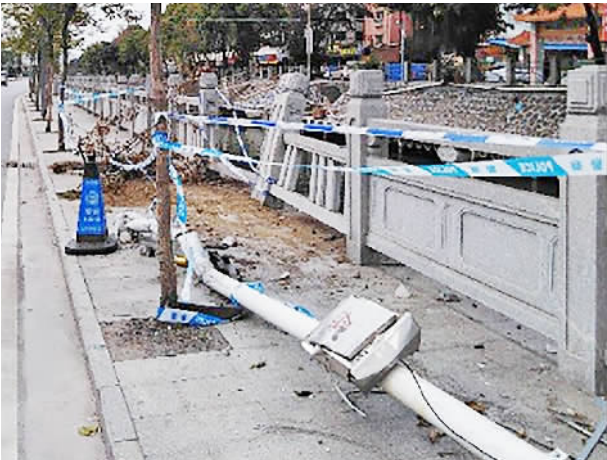
■护栏破损存安全隐患。
