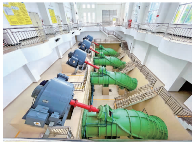
■丹灶镇银河电排站安装了4台1800ZXB-2.7型斜式轴流泵。
