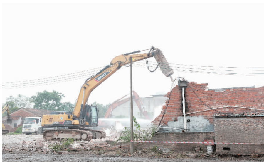
■挖掘机、洒水车同时作业,大片低端厂房应声倒下。 珠江时报记者/方智恒 摄
