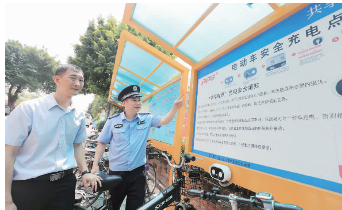
佛山泛家居电商创意园内设置了电动车充电桩，安装有智能插座、喷淋设备等安全装置，供园区人员使用。
