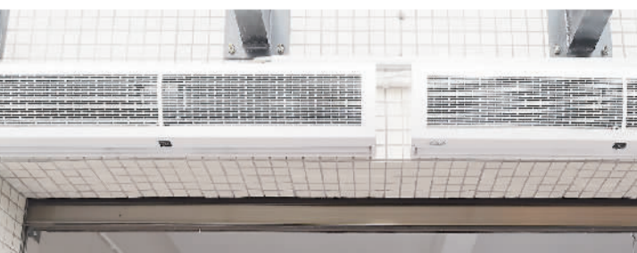
▲安装在垃圾处理室门上方的两台风帘机,成为减少臭味的关键。
