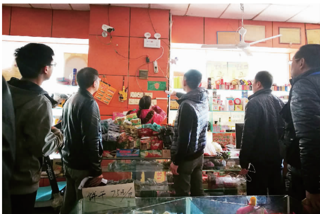
督导组发现一家店铺仍存在乱拉乱接电线问题。
