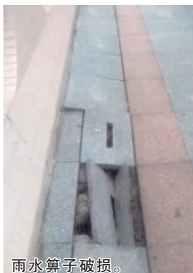
雨水算子破损。
