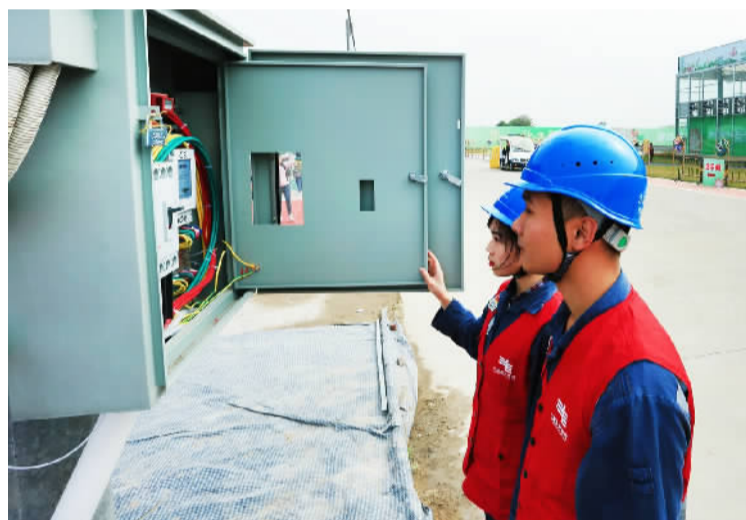
南海供电局里水供电所党员服务队为万顷园艺世界检查用电设备。
