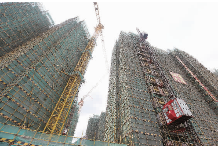
罗村社区寨边明苑(农民公寓)已顺利封顶。 见习记者/廖明璨 摄
