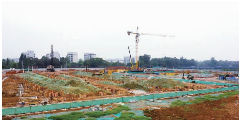
广东思豪内高压科技有限公司增资扩产项目正在火热建设中。(通讯员供图)
