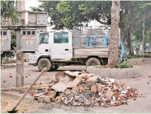
■建筑垃圾没及时清走。
